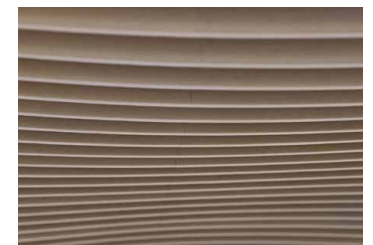
Des vagues au-dessus de la tête: ce qui est très agréable au niveau optique – les plinthes sont d'ailleurs fabriquées à base de bouteilles PET recyclées – garantit également un niveau sonore réduit très agréable dans cette pièce très haute.
